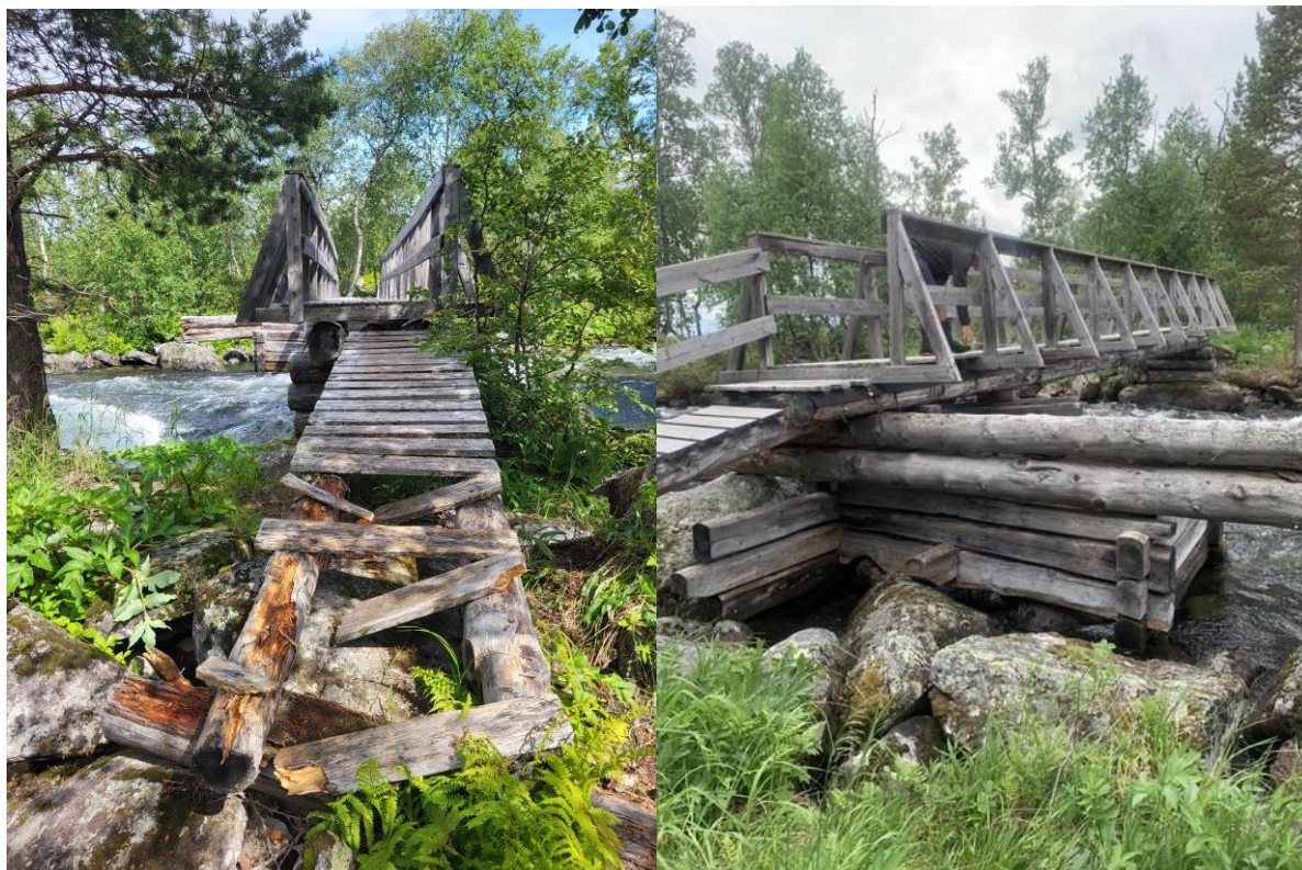
Bilde av råteskader/ vedlikeholdsbehov
