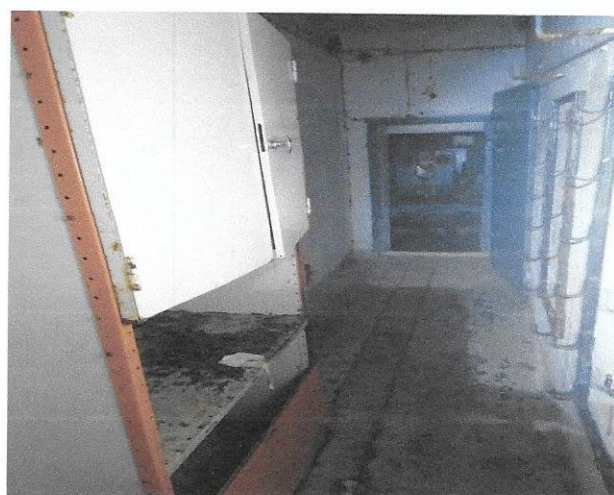
Inngang til kanonstandplass med ammunisjonsrom til venstre og høyre Takhøyde 2,8 m Bilde 11
