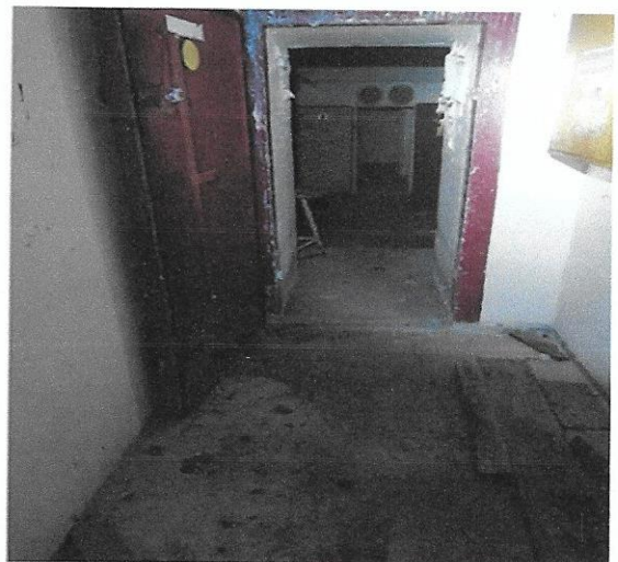
Gass og detonasjonssluse fører inn til hovedanlegget bilde 4 Takhøyde over 2,6 m
