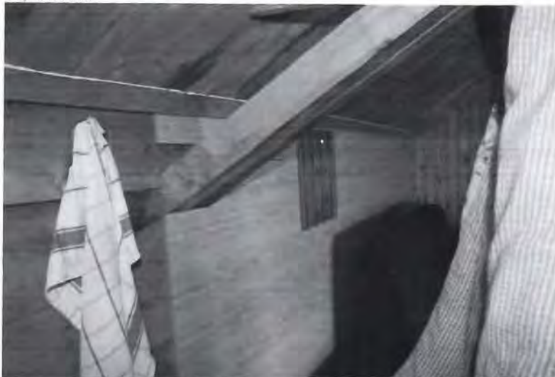
Plategledning innvendig på veggane. Takbukk. Misfarging av himling – fuktig. Akryl fuge (kvit streng) for tetting.
