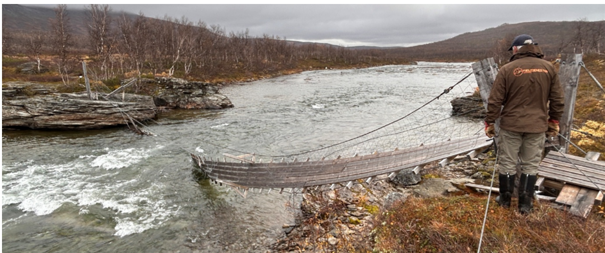
Ødelagt bru oktober 2025 før fjerning
