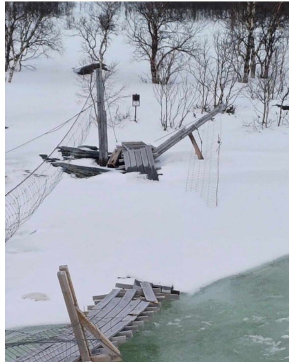
Ødelagt hengebru april 2025
