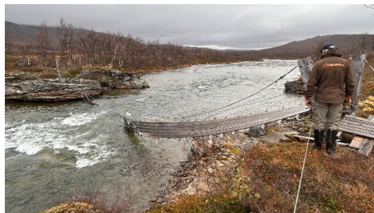
Havarent hengebru over Tiplingelva oktober 2025
