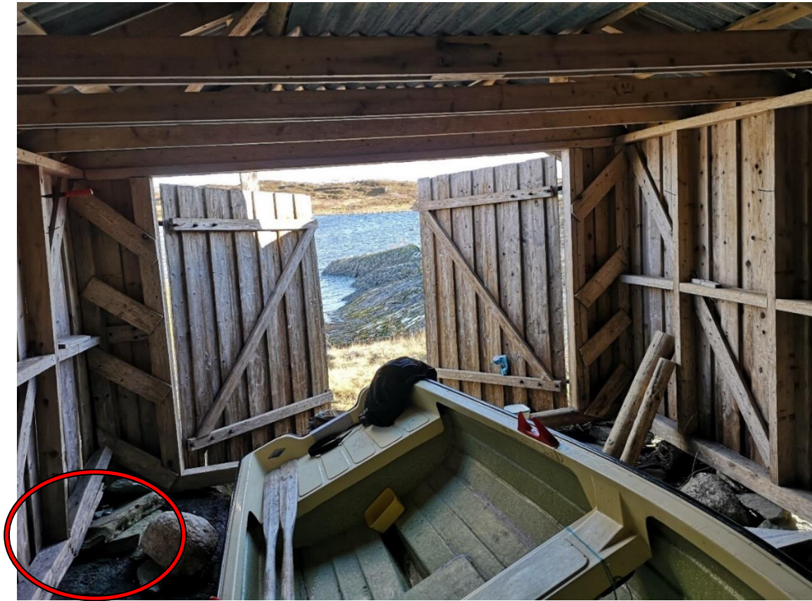
Figur 5. Naust innvendig med knekt konstruksjon markert med rød ring. Foto R. Elnan 18.10.22.
