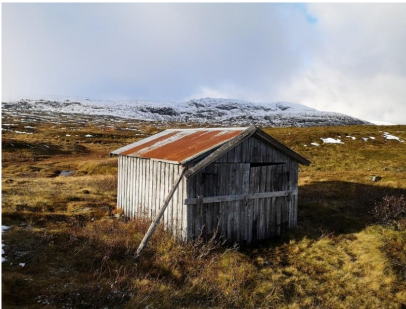
Figur 3. Båtnaust ved Blyvatnet. Skeive dører og løse/råtne materialer. Foto R. Elnan 18.10.22.
