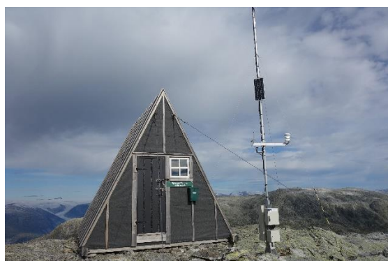
Figur 12. Kontroll av masta avdekket at plassering av solcellepanelet ikkje var i samsvar med vilkåra.
