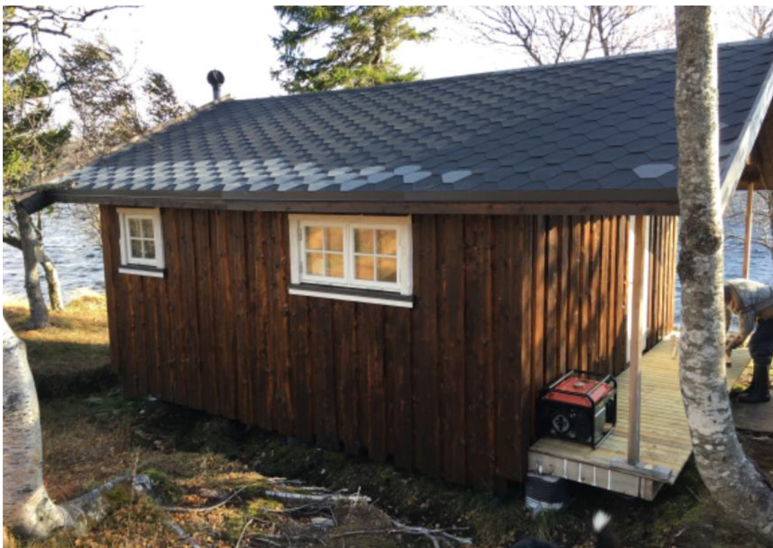
Fig. 3: Bilde av den omsøkte plattingen og det overbygde taket på uthuset/annekset ved hytte Skjækervatnet 11.
