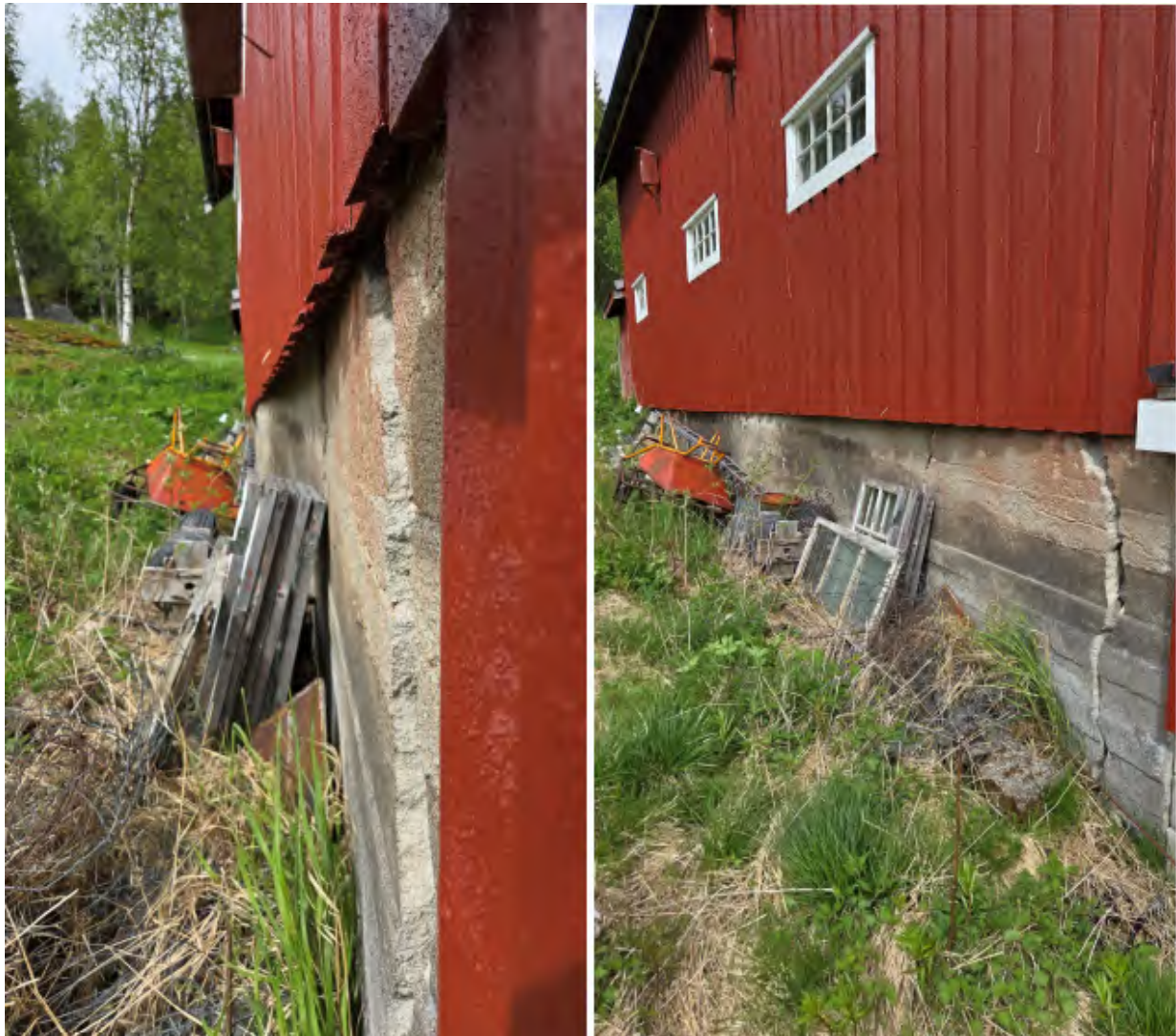
Figur 2: Bilder som viser ødeleggelser i grunnmuren på låven.
