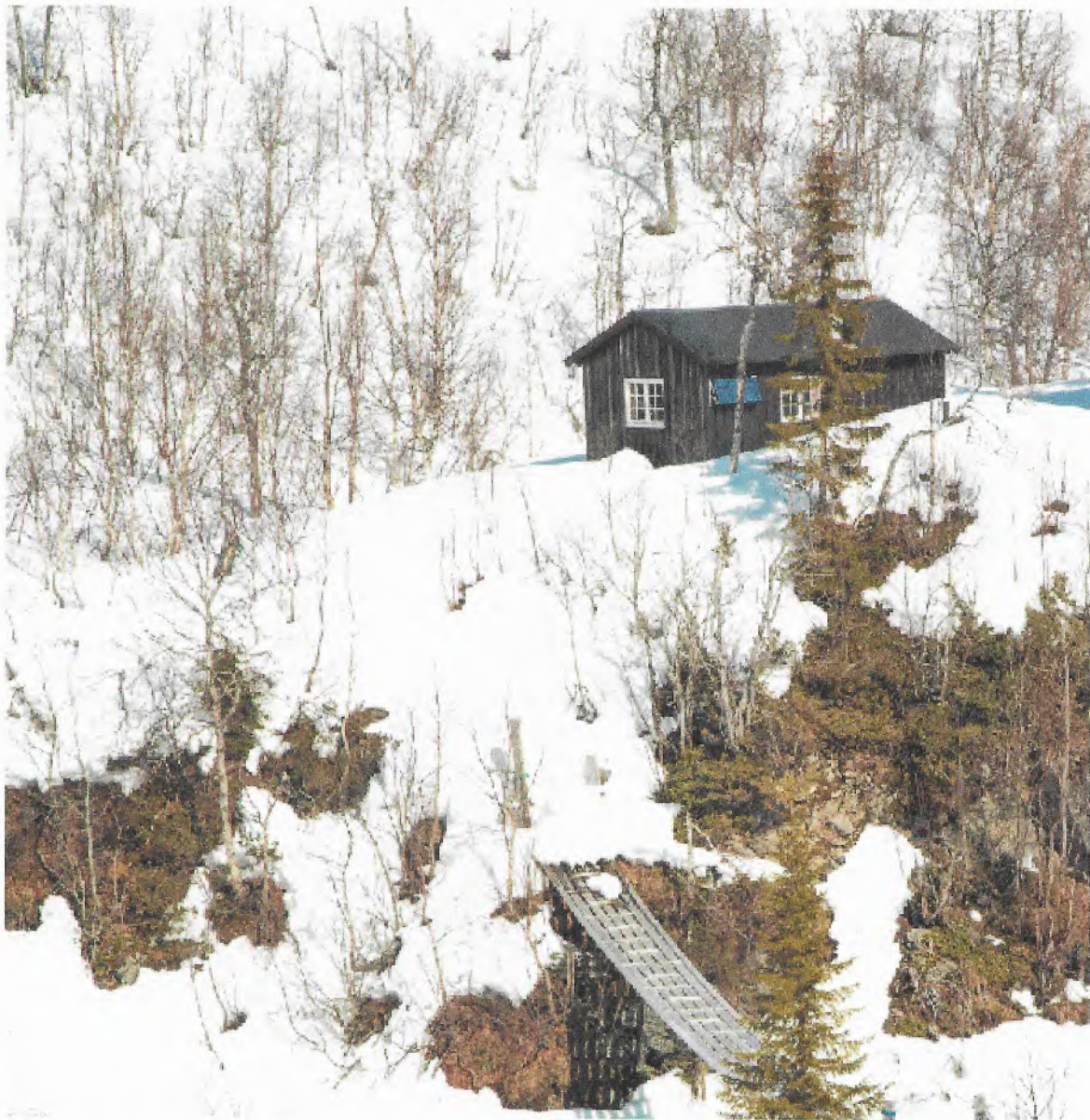
Vårbilde fra Almdalsbrua: Hengeskavl fra hytta går normalt et godt stykke ut på brua midtvinters, og det ligger ofte snø/is på dekket. Å styre trafikk hit vinterstid vil medføre stor risiko for ulykker.
