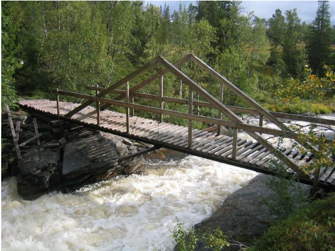
Flom med isgang Kastjønnelva, brukar står igjen ned til høgre bilde
