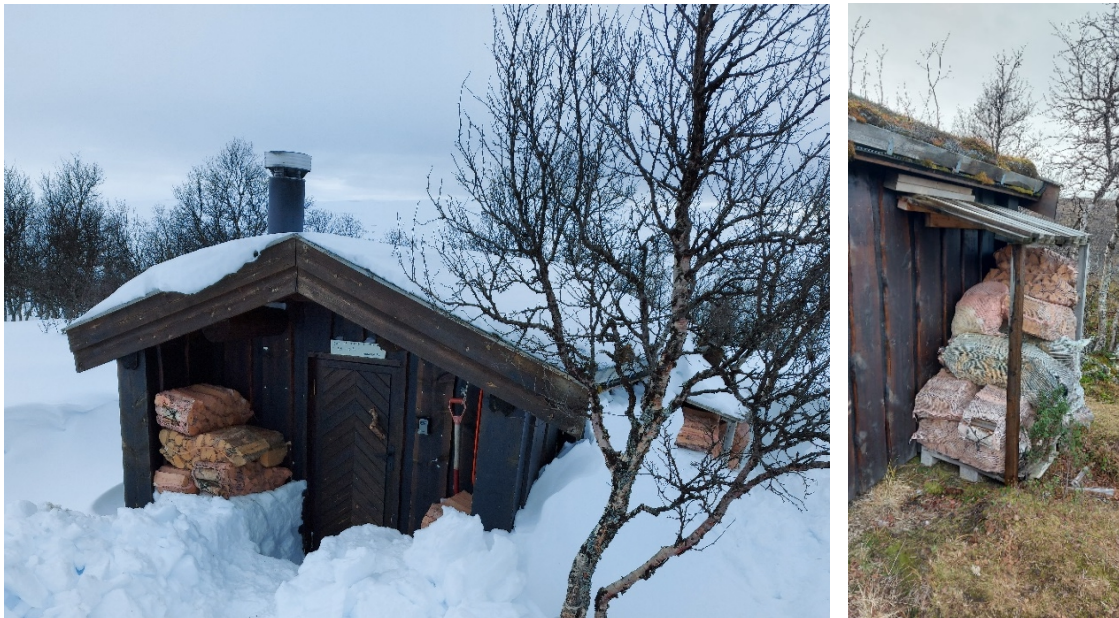
Figur 2: Bildene viser dagens vedlagerløsning - til venstre er inngangsparti til bua, og til høyre er tak-utstikket plassert på nordveggen.
